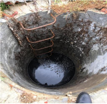
Fotografía 5. Sistema de Pozos
