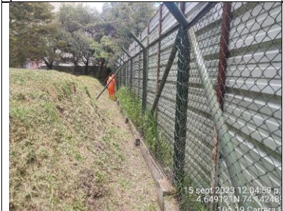
Se observa arreglo de cerramiento definitivo en el sector 2 de la RDHTE.
