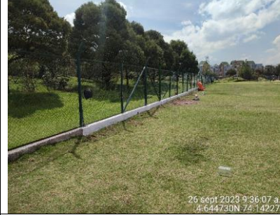
Se observa arreglo de cerramiento definitivo en el sector 1 de la RDHTE
