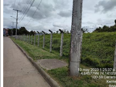
Se observa instalación de malla tipo gallinero en el sector 1 de la RDHTE.
