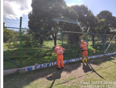
Se observa arreglo de cerramiento definitivo en el sector 1 de la RDHTE.
