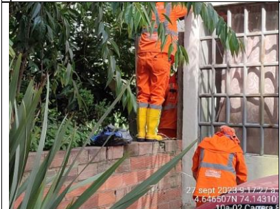
Se observa arreglo de cerramiento provisional en el sector 1.1 de la RDHTE.
