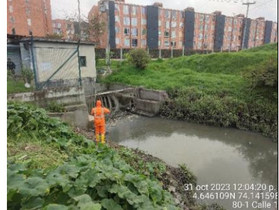
Se observa recolección de RSO en la rejilla del canal castilla en el sector 1 de la RDHTE.
