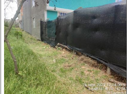
Se observa arreglo de cerramiento provisional en el sector 2 de la RDHTE.
