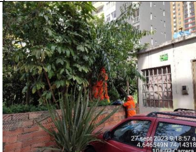
Se observa arreglo de cerramiento provisional en el sector 1.1 de la RDHTE.
