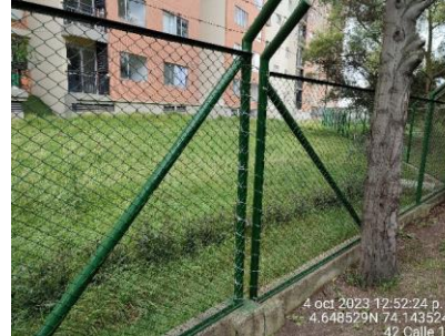
Se observa arreglo de cerramiento en el sector 2 de la RDH Techo.
