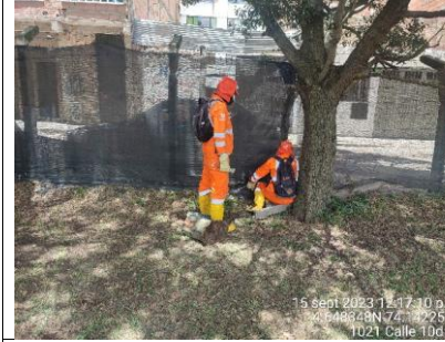
Se observa arreglo de cerramiento provisional en el sector 2 de la RDHTE.
