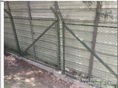
Se observa arreglo de cerramiento definitivo en el sector 2 de la RDHTE.
