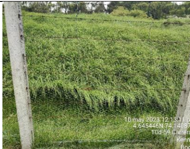
Se observa instalación de malla tipo gallinero en el sector 1 de la RDHTE.
