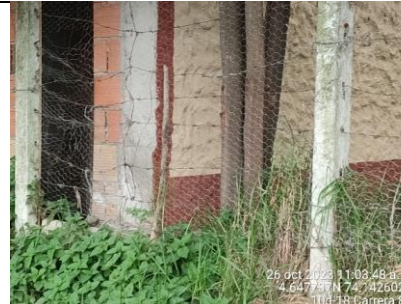
Se observa arreglo al cerramiento provisional en el sector 2 de la RDH Techo.
