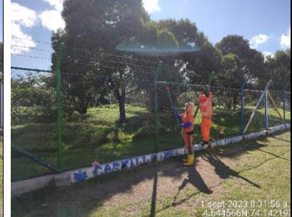
Se observa arreglo de cerramiento definitivo en el sector 1 de la RDHTE.
