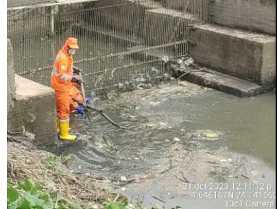
Se observa recolección de RSO en la rejilla del canal castilla en el sector 1 de la RDHTE
