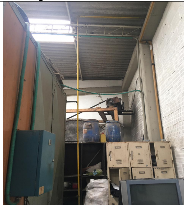
Fotografía No 4. Conexión gas natural al horno.
