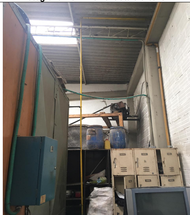
Fotografía No 4. Conexión gas natural al horno.
